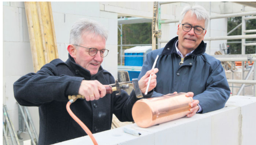
Auch auf dem Bau machen Lebenshilfe-Geschäftsführer Gerhard Suder und Soltaus Bürgermeister Olaf Klang eine gute Figur. Erst löst sie die Zeitkapsel zu, mauern sie dann ein und setzen damit den Grundstein für den neuen Kita-Bau an der Winsener Straße. Foto: tv
